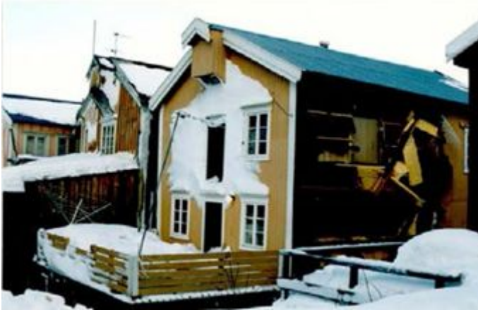
Figur 2: Skade på bygning som følge av skredvind fra snøskred utløst fra fjellet Stortuva, Mosjøen, Norge 29.02.1996 (bilde: NGI).
