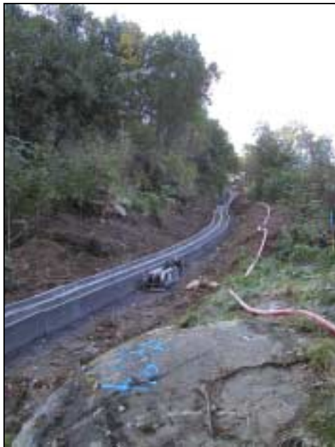
Figur 3: Det er mulig å få til anleggsarbeidet uten å benytte seg av en anleggsvei ved siden av kabelgrøften. Dette er aktuelt der terrenget gjør det umulig eller svært uheldig med en slik veg. Men dette medfører praktiske ulemper med dertil økte kostnader. Bildet viser kabelgrøft for en 132 kV kabel med to kabelsett. (Foto: BKK)
