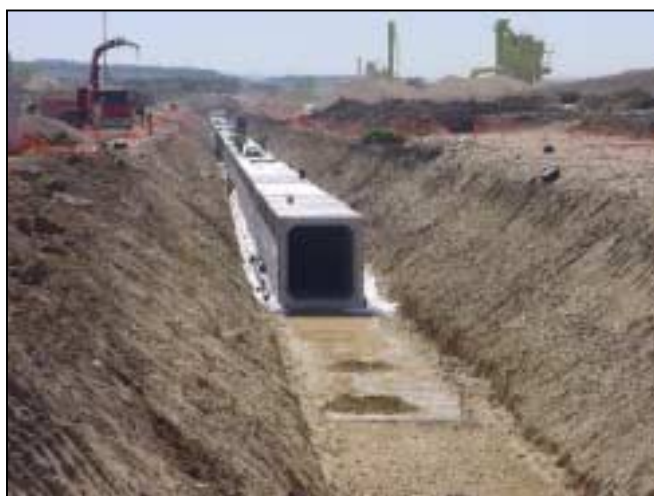
Figur 4: Bilde av en 420 kV kabelkulvert i Madrid (Foto: Statnett)
