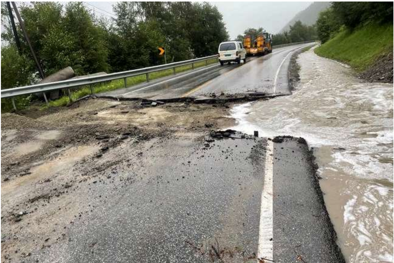
Ødelagt vegbane etter ekstremværet Hans på riksveg 15, Lom-Vågå. Foto: Asbjørn Stensrud
