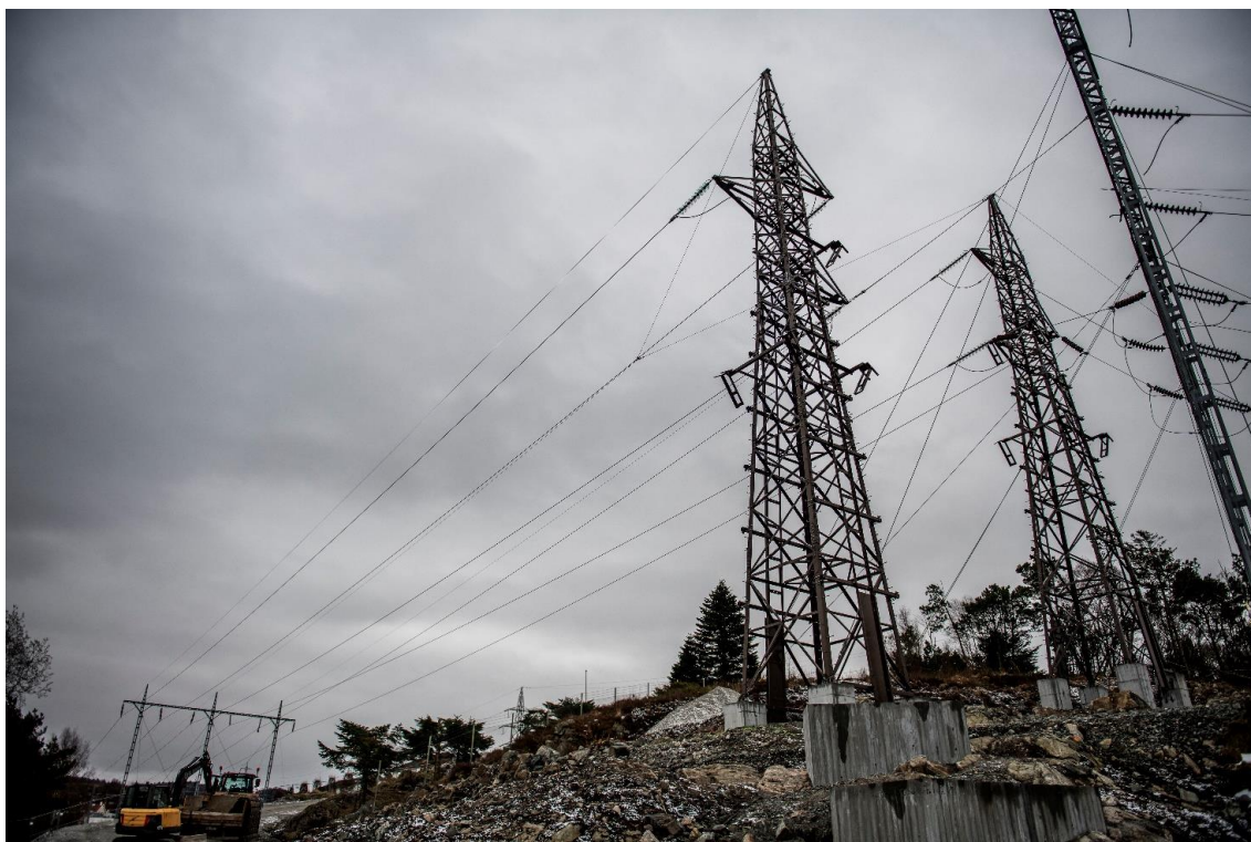
Oppgradering av Tronsholen transformatorstasjon med nytt innendørs anlegg, samt fornyelse av strømmast og kabler inn til stasjonen. (Foto: Fredrik Ringe, 2021)
