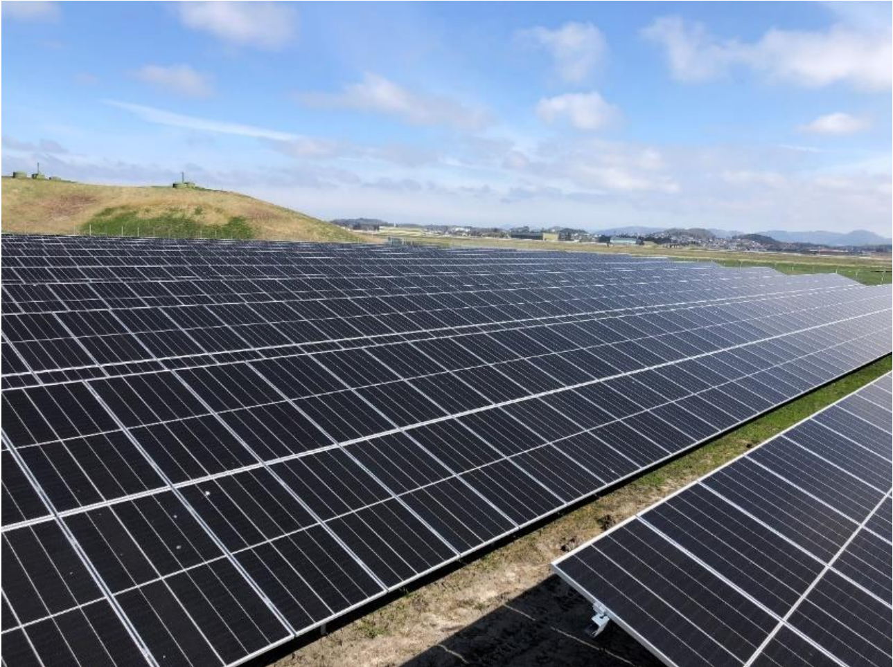
Bakkemonterte solcelleanlegg i Stavanger Lufthavn Sola (Bilde: Avinor)
