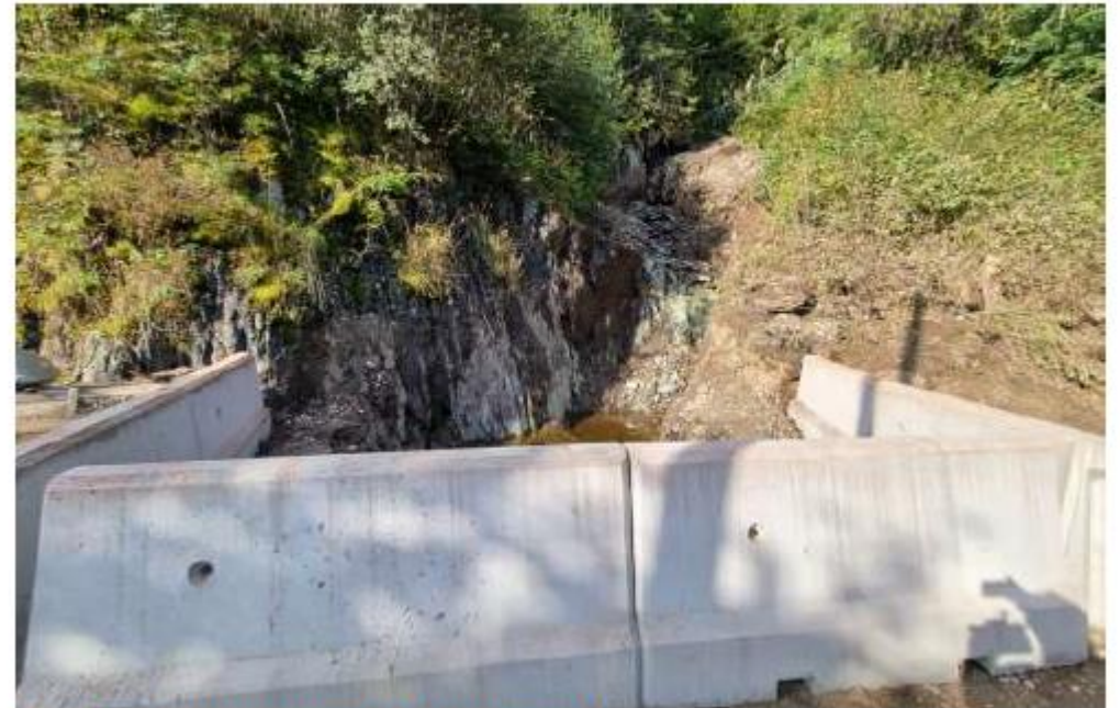
Figur 16. Sedimentasjonsbasseng nær Stasjonsveien 54.
