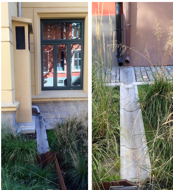
Frakoblet takrenner & regnbed, Oslo
