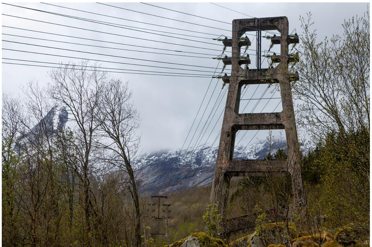
Fig. 7 Glomfjord kraftledning. En av mastene som er under fredning. Foto: Dag Endre Opedal/NVIM/Statkraft. 2016.
