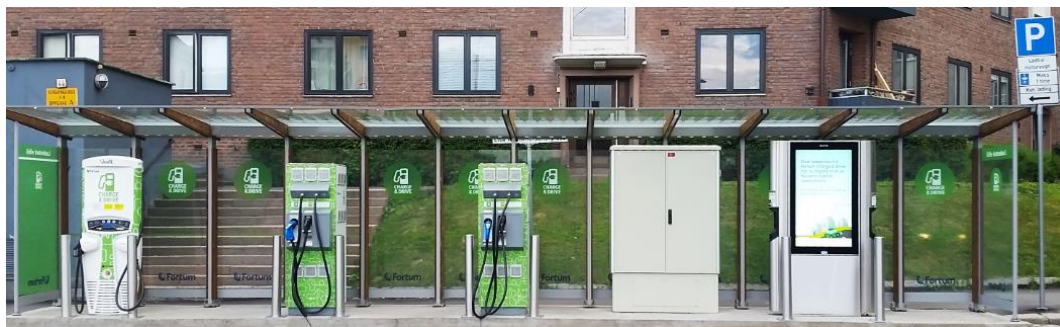
Figur 3-3 Hurtigladestasjon med tre uttak på 50 kW og to på 22 kW. Foto: NVE
