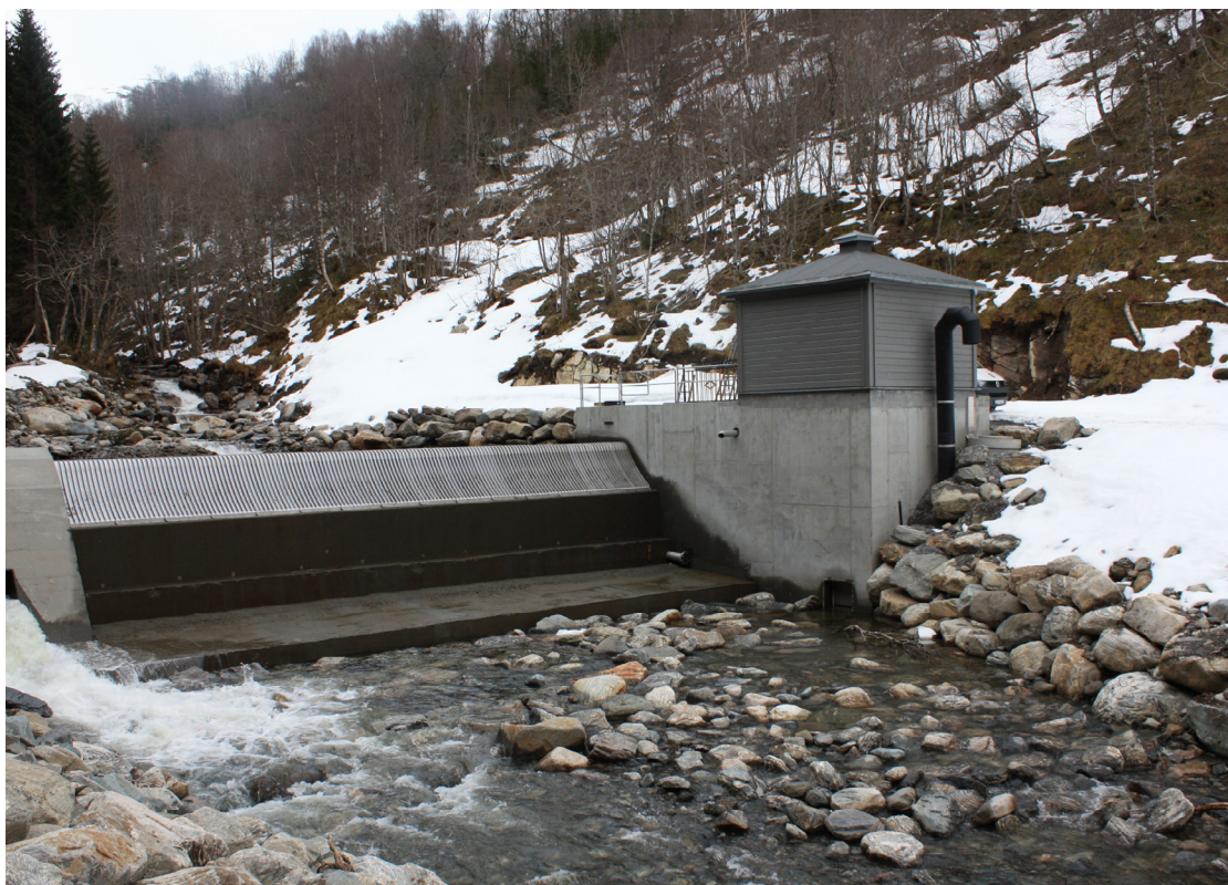
Coandainntak i drift ved Dyrkorn kraftverk, Stordal, Møre og Romsdal. Foto: Tafjord Kraftproduksjon AS.
