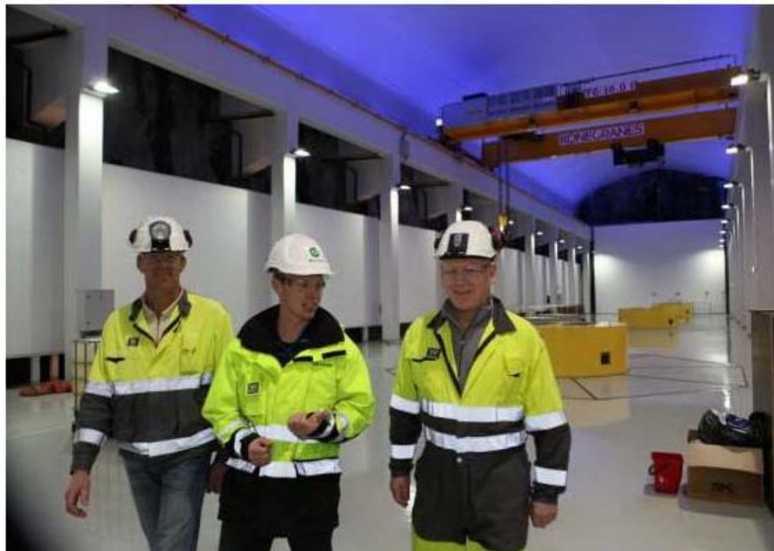
SØNNÅ KRAFTVERK: Prosjektleder Harald Kjetil Glendrange (t.h.), Elkem-direktør Svein Ilstad og byggeleder Helge Nilsson (m.h.) går gjennom tunnelen under bygging. De er inne i nye Sønnå kraftverk, en kilometer inne i fjellet i Sauda. Foto: Per Lars Tonstad
